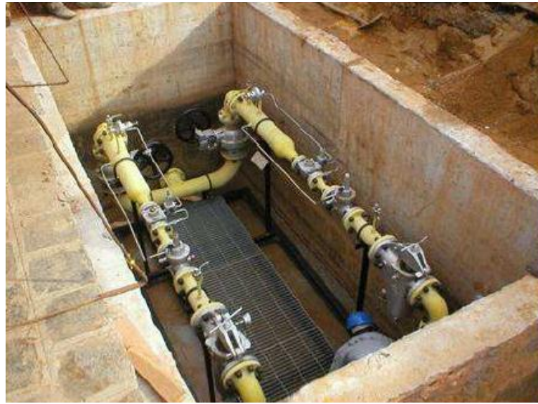
Figura 1 - Fotografia de exemplo de ERP instalada em uma caixa subterrânea. Fonte: Compagas.
