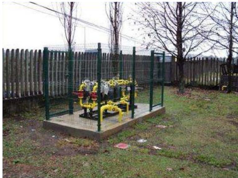
Figura 2 - Fotografia de exemplo de EMRP instalada. Fonte: Compagas.
