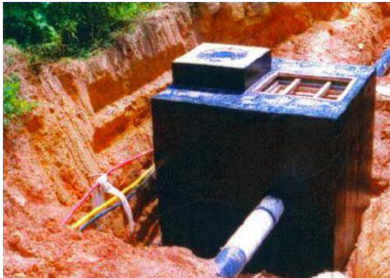
Figura 3 - Fotografia de exemplo de Caixa de VBI instalada. Fonte: Compagas.
